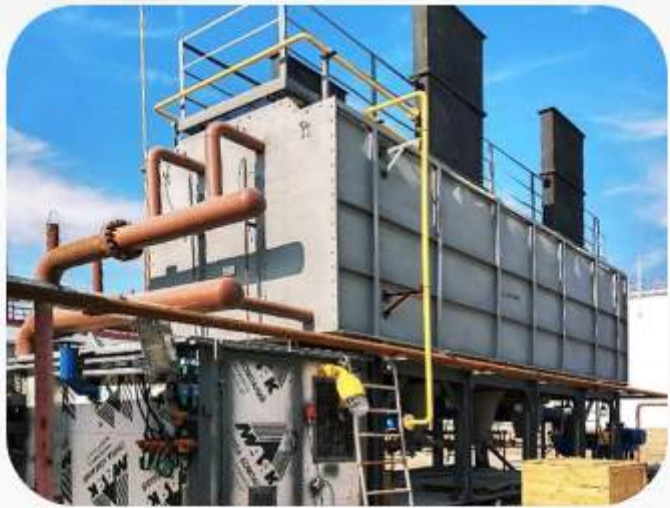
Печи подогрева нефти
