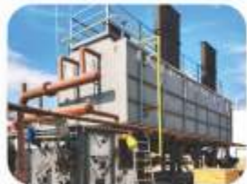
Печи подогрева нефти
