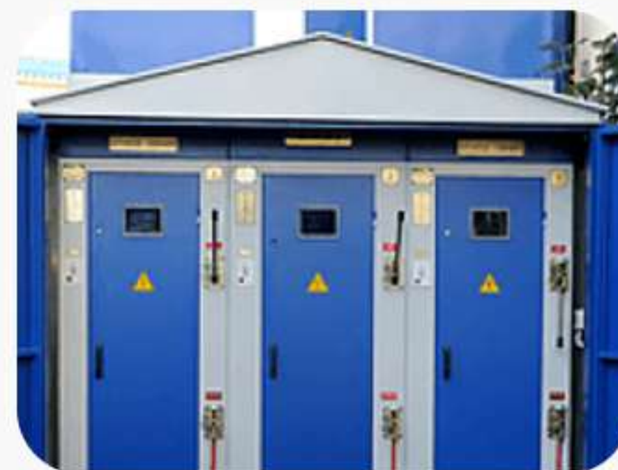
Трансформаторы (ТОО "УТЗ")
